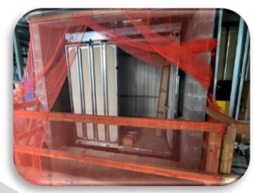
Cabina de ascensor
